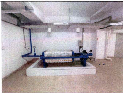
污泥脱水系统
