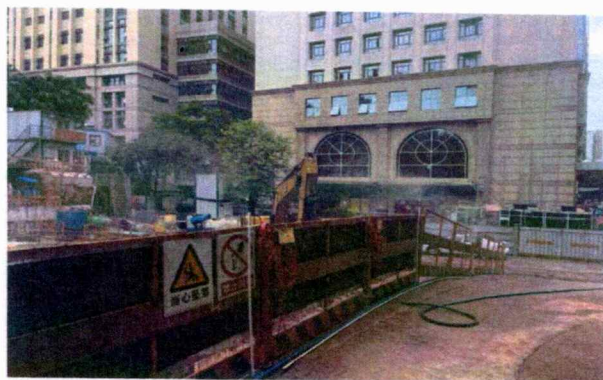
施工周边扬尘抑制喷雾装置 3
