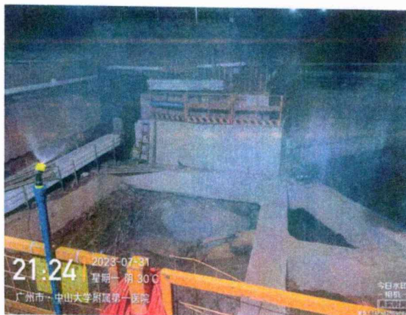
施工周边扬尘抑制喷雾装置 4
