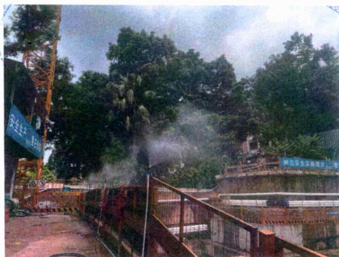
施工周边扬尘抑制喷雾装置 1
