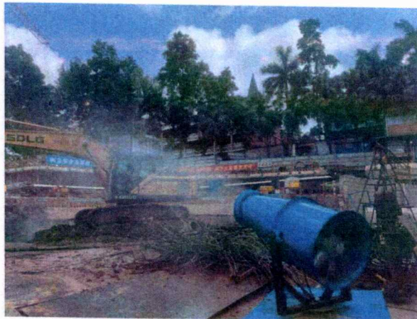
施工周边扬尘抑制喷雾装置 2
