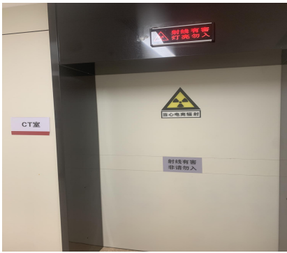
CT 室门灯联锁及电离辐射警告标志
