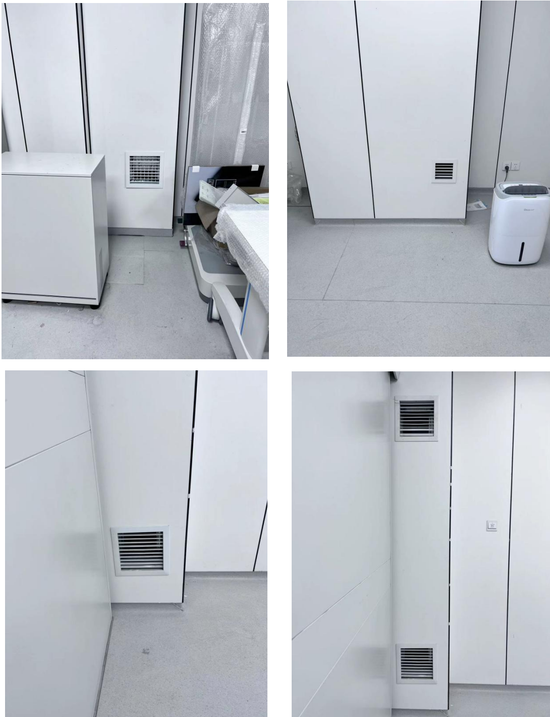
图 3-9 通风装置现场照片
