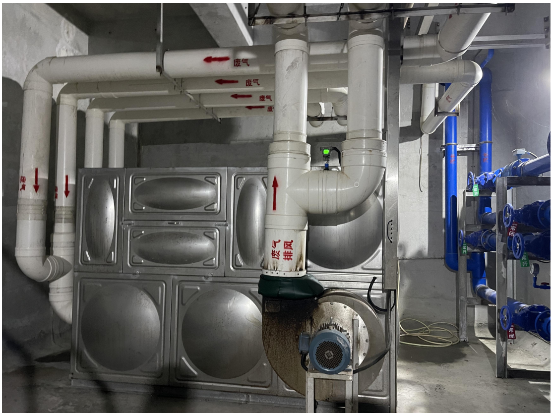
图 5-5 活性炭吸附+紫外线消毒设施照片
