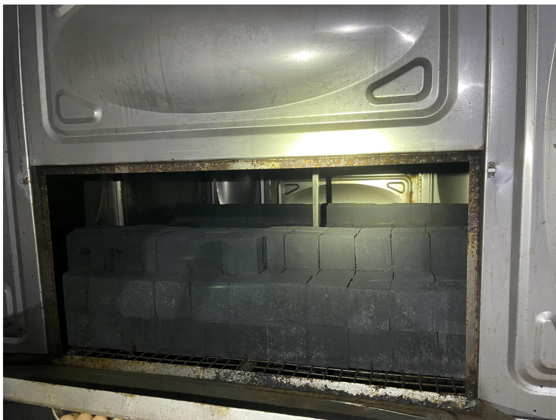
图 5-6 活性炭吸附+紫外线消毒设施内部照片
