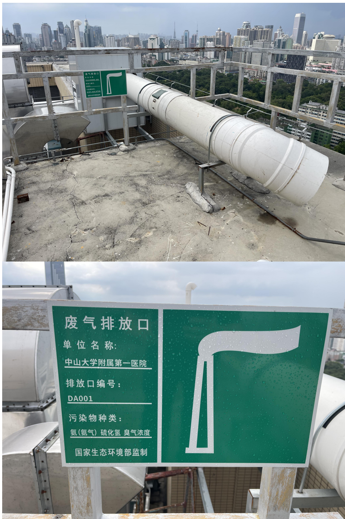
图 10-1 DA001 废气排放口及标志牌照片
