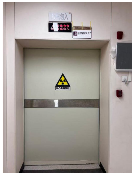
CT 模拟定位 2 机房大门
