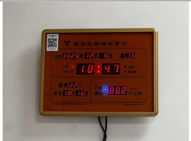
固定式剂量报警仪（控制室部分）
